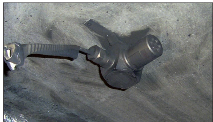
Fot. 1. Detektor po pożarze w pomieszczeniu. Wyraźnie widać, że produkty stałe spalania oblepiają urządzenie i zatykają wloty uniemożliwiając detekcję
